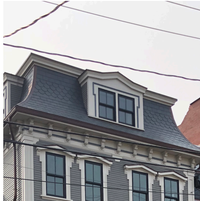
Las formas del techo, como este techo mansarda, contribuyen al carácter visual general de una cuadra, especialmente cuando se utilizan cambios en profundidad y material.
