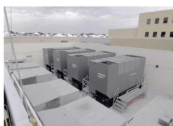
On-site Energy Generation Generación de energía en el sitio
