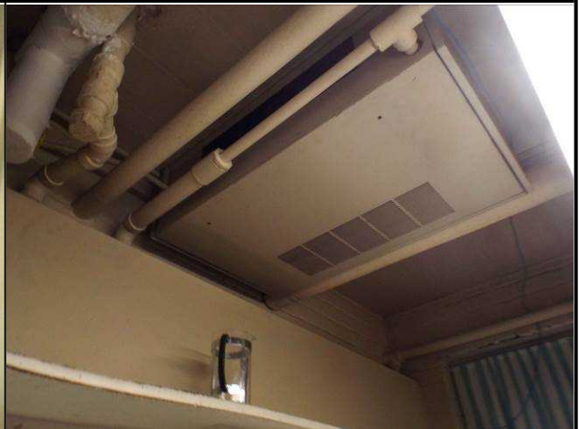
Fan coil unit
