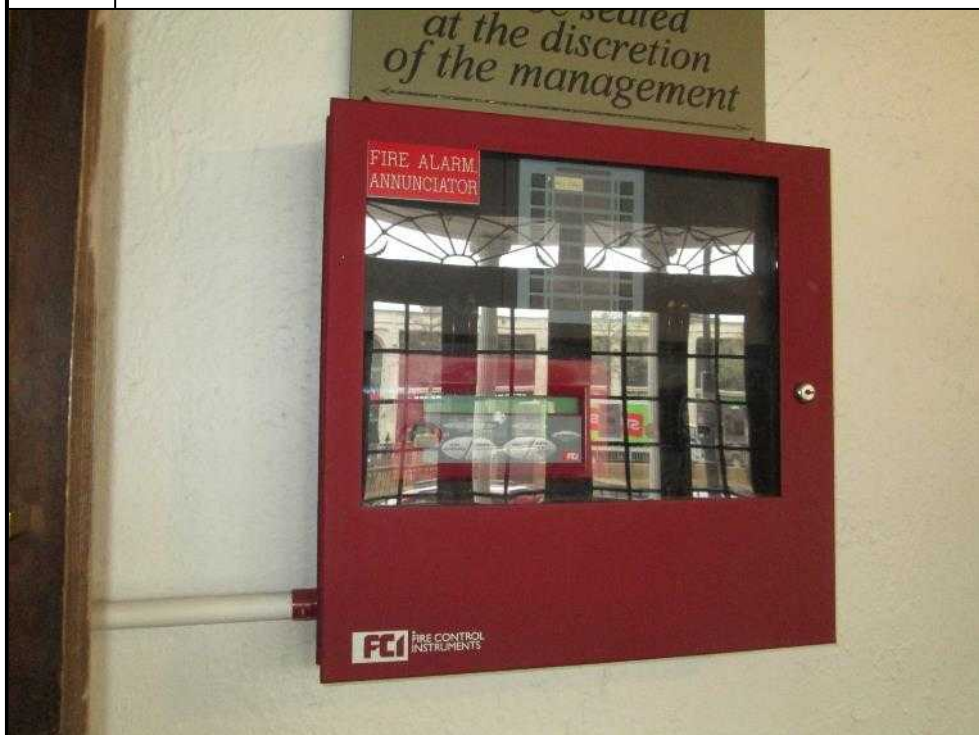
24. Fire alarm annunciator panel
