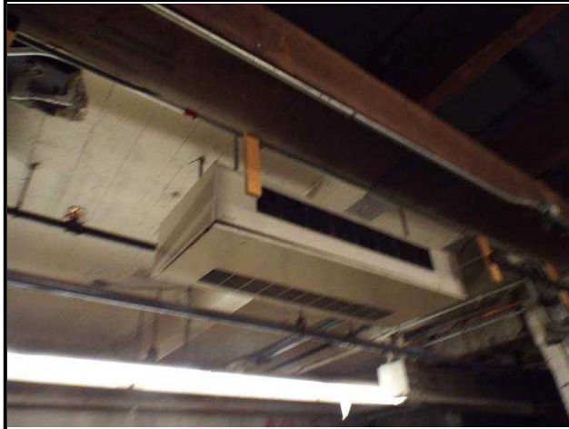
Fan coil unit
