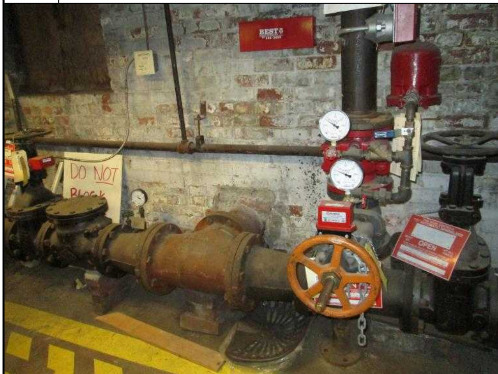
34. 258 Huntington sprinkler riser
