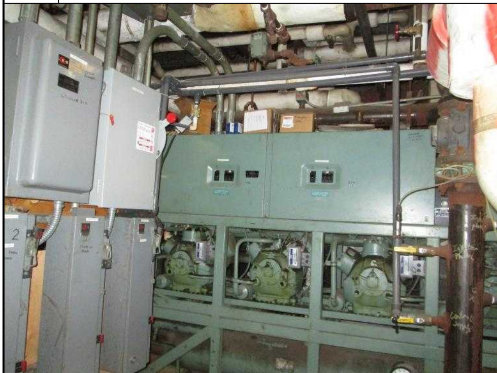
30. Air handler unit
